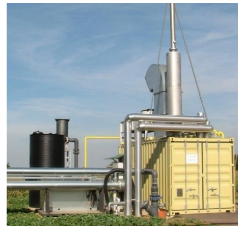
CHP-Unit 190 kW el
